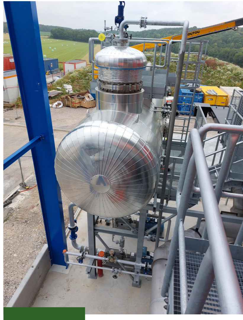
Chaudière biomasse du site historique d'Ingredia à Saint-Pol-sur-Ternoise (Pas-de-Calais), qui produit des ingrédients laitiers (poudres de lait, protéines et additifs).
