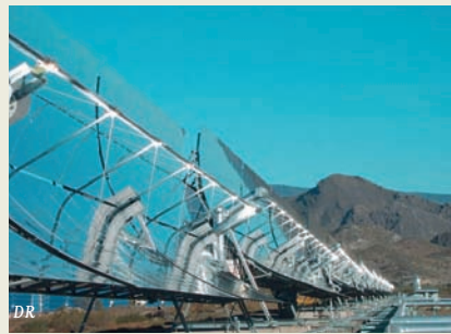
Collecteurs cylindro-paraboliques de la plateforme solaire d'Almería/Cylindrical-parabolic collectors of the solar platform of Almería.
